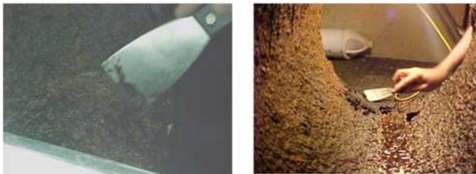
Fig. 2 Aspecto de las superficies interiores de las tuberías después de raspadas.
